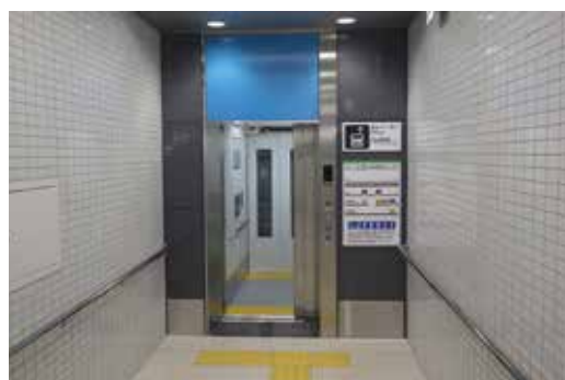
地下鉄駅改札内乗換エレベーター
