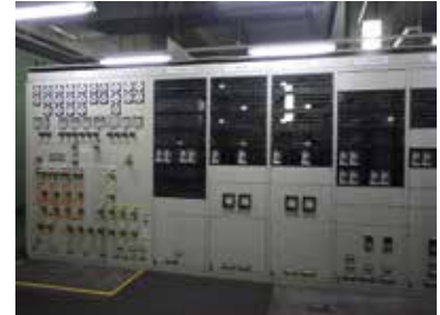
第2栄変電所の変電設備
